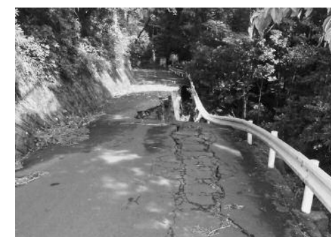
大雨により路肩が崩壊した町道湯ヶ岡赤川線
