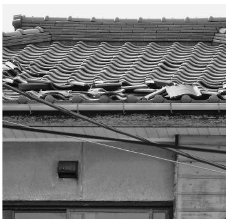
瓦が飛ぶなどの被害が多く見られた
