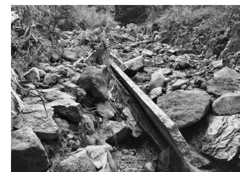
台風により被災した片瀬わさび田水路
