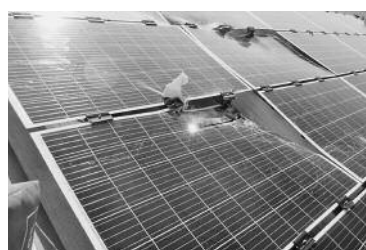
台風被害でソーラーパネルが発火した状態
