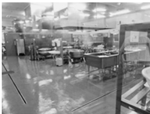
老朽化が進む給食センター
