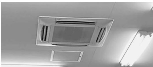
老朽化が進む給食センター空調設備
