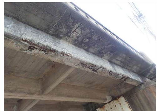
写真－2 主桁の鉄筋露出 Ⅳ（緊急に措置を講ずべき状態）
