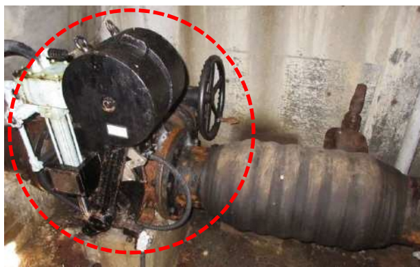
写真3-9 長坂配水池に設置されている緊急遮断弁
