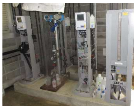
写真 4-6 近年更新した計測設備
