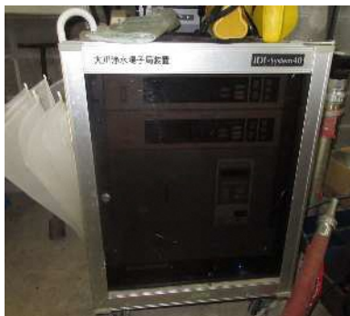
写真 4-5 老朽化した通信設備
