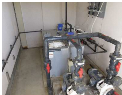
写真 3-7 塩素注入設備
