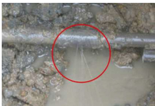
写真4-3 塩化ビニル管の漏水状況
